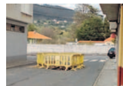
El socavón ha obligado a impedir el tráfico. XOSÉ CHEDA
